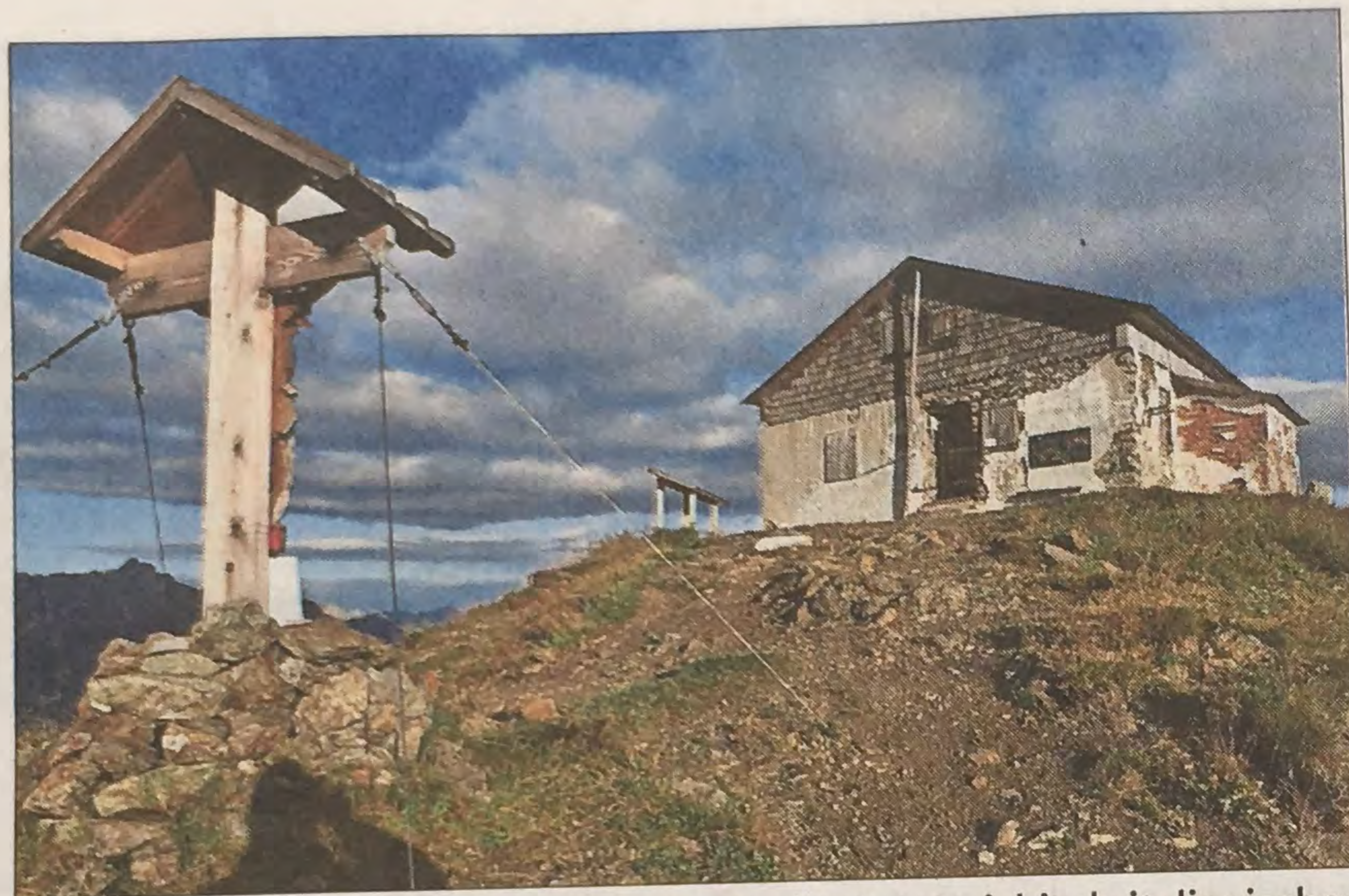
Das sanierungsbedürftige Helmhaus an der österreichisch-italienischen Grenze.
